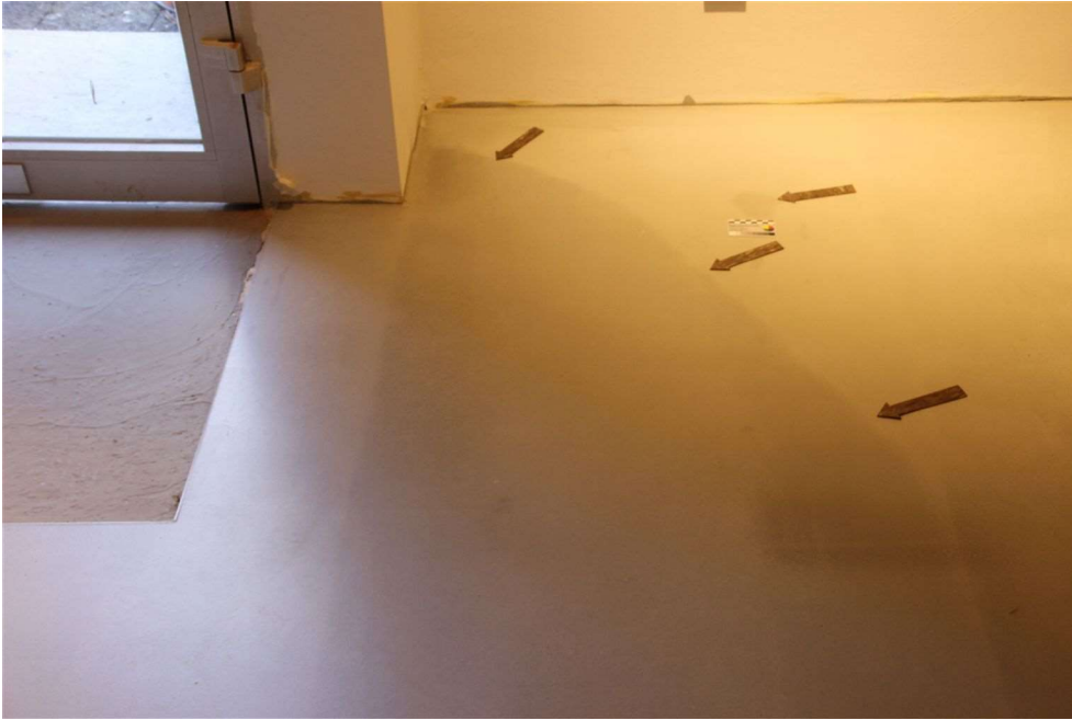
Bild 2: Klar erkennbare Umschlagkante des Abdeckmaterials
