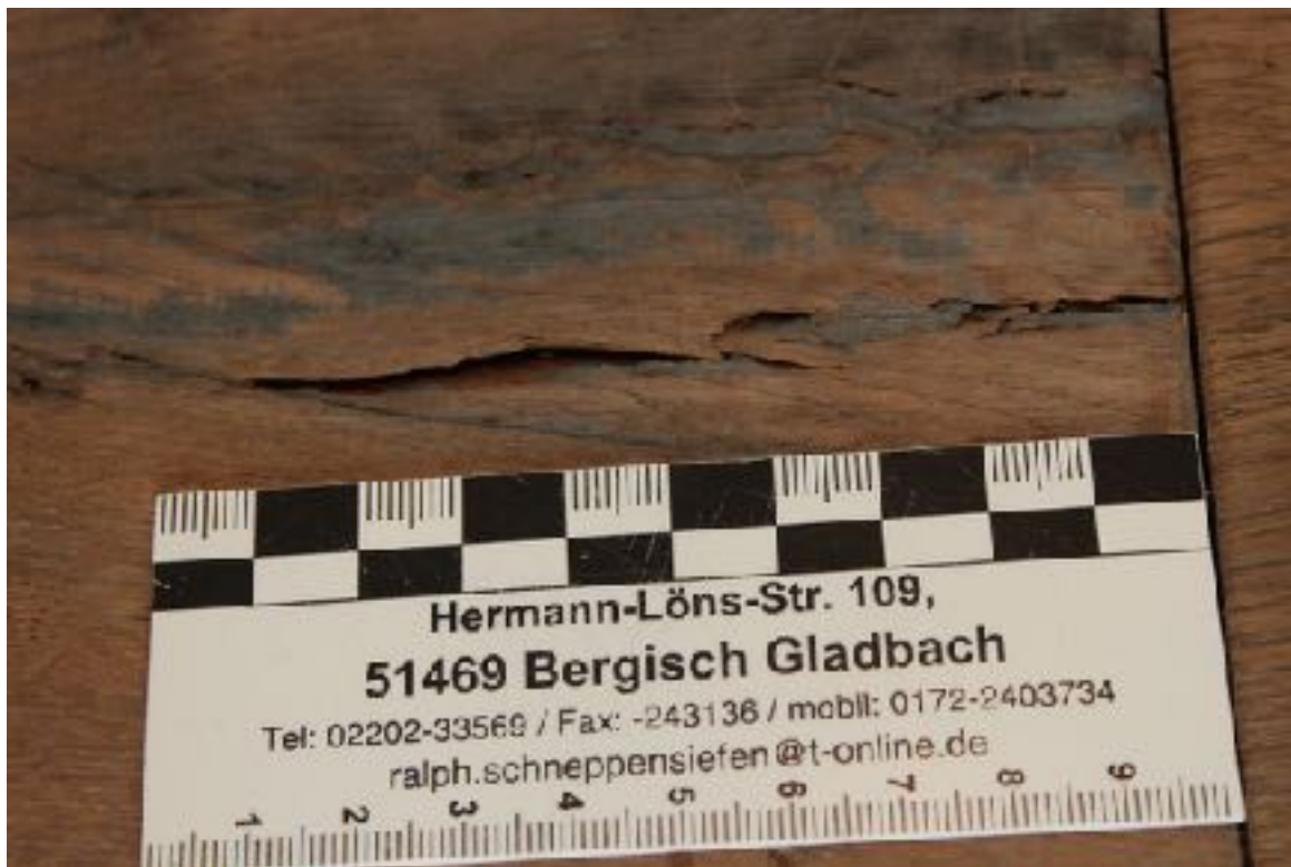
Offene durchgängige Risse
